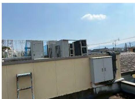
屋上にあるエアコン室外機と分電盤
