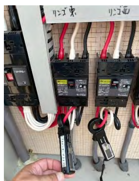
分電盤内に測定器ロガーを取付
